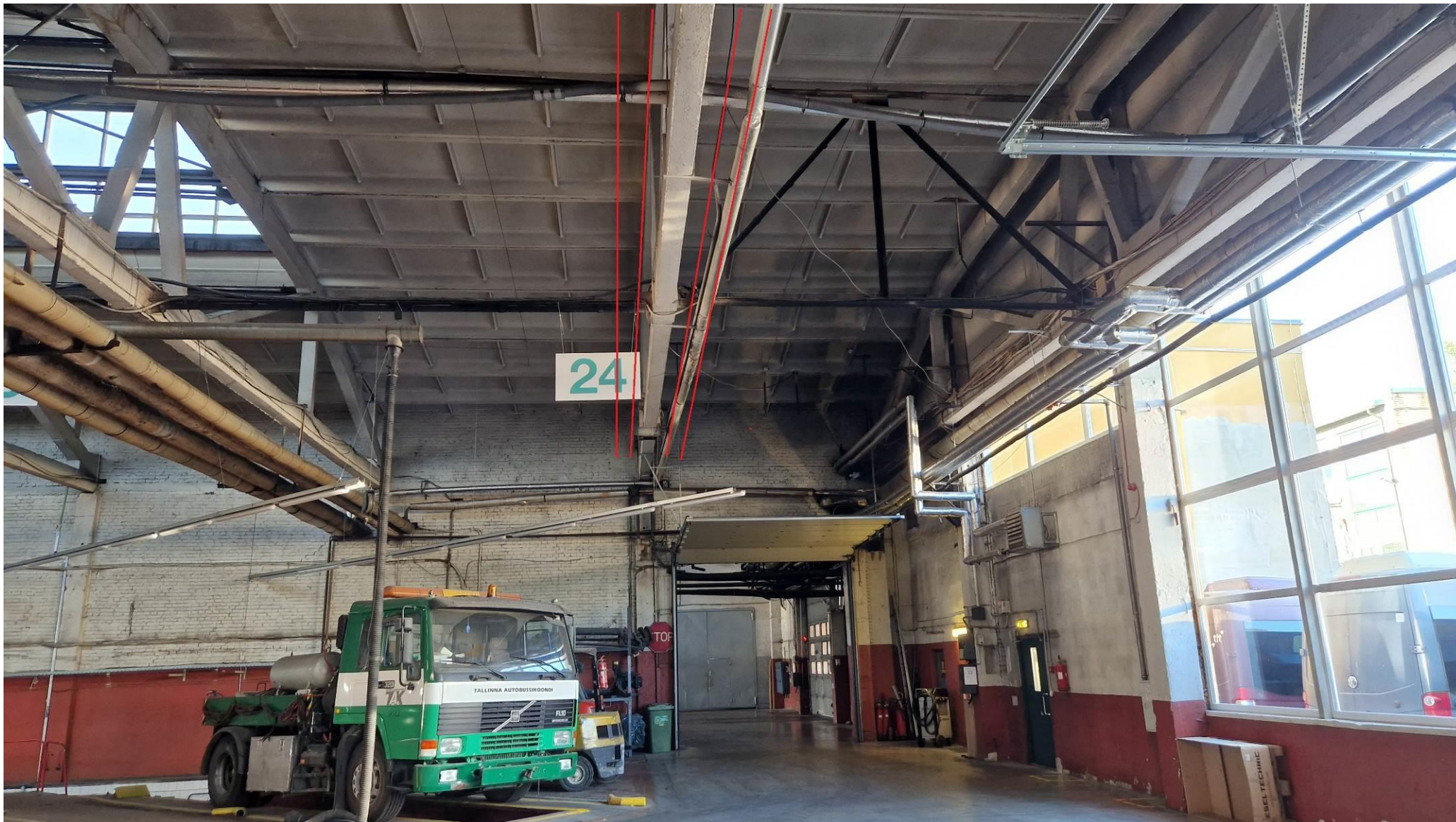
Foto nr 10: Vaade töökojast. Vaatel on näha võimalik trasside paigutus (administratiivhoone ja pääslohoone trass).
