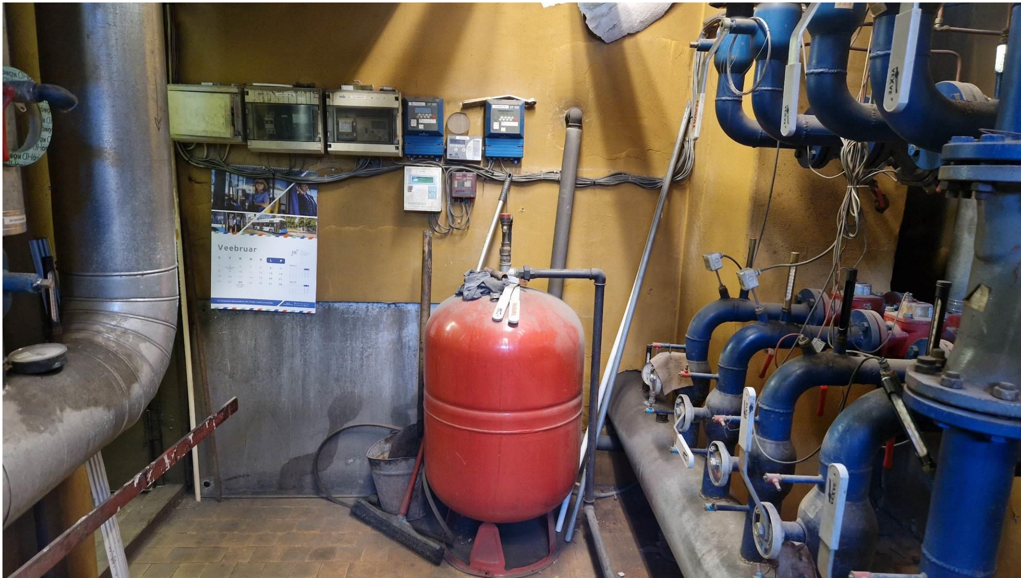
Foto nr 8: Vaade soojussõlmest. Vaatel on näha olemasolev likvideeritav kollektor ja amortiseerunud soojuse mõõteseadmed.
