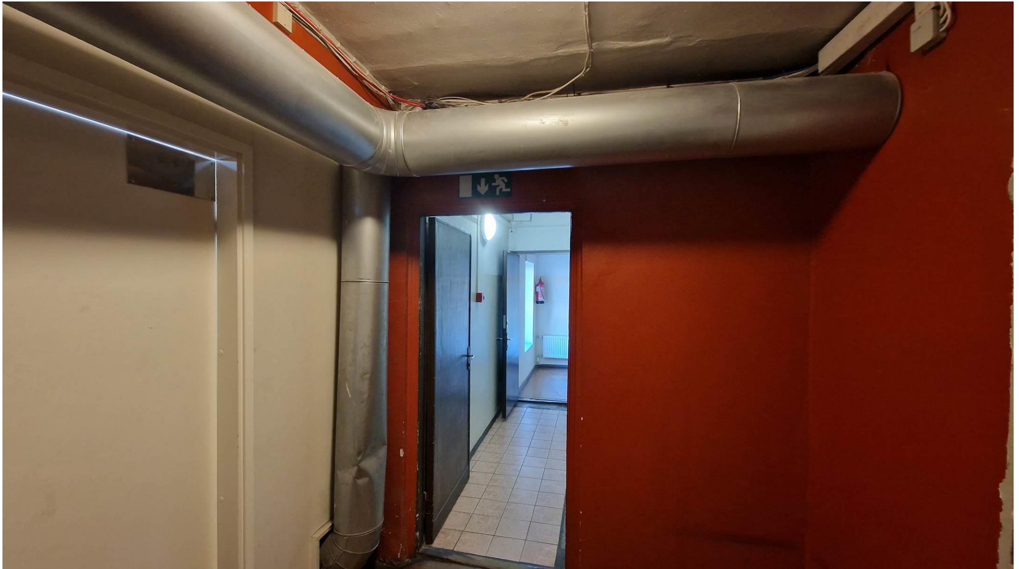
Foto nr 19: Vaade administratiivosast. Vaatel on näha võimalik trasside paigutus (administratiivhoone trass, mis läheb asendamisele).
