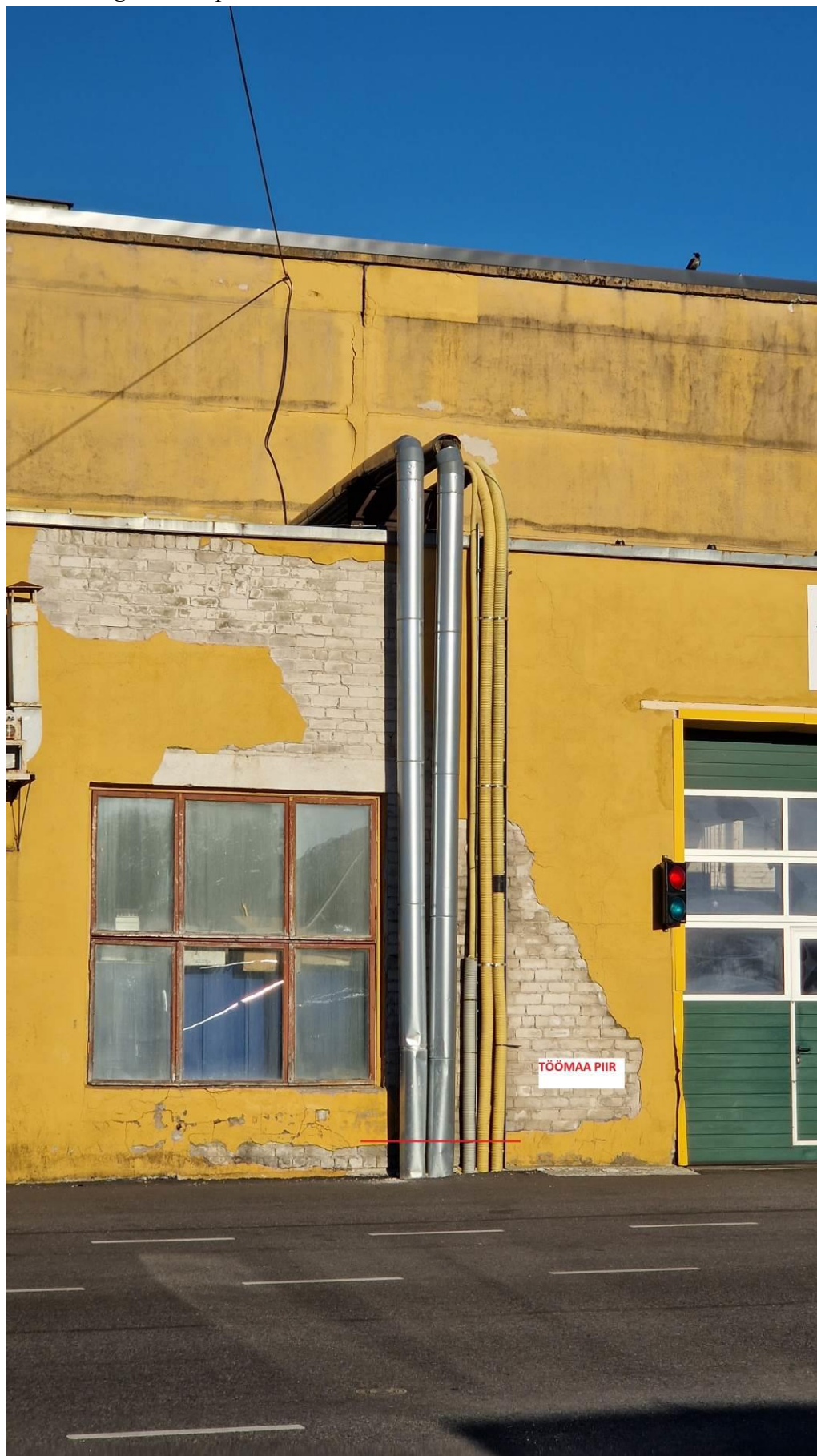
Foto nr 22: Vaade töökoja välisseinast (loodest). Vaatel on näha asendatavad pesulahoone trassid ning töömaa piir.
