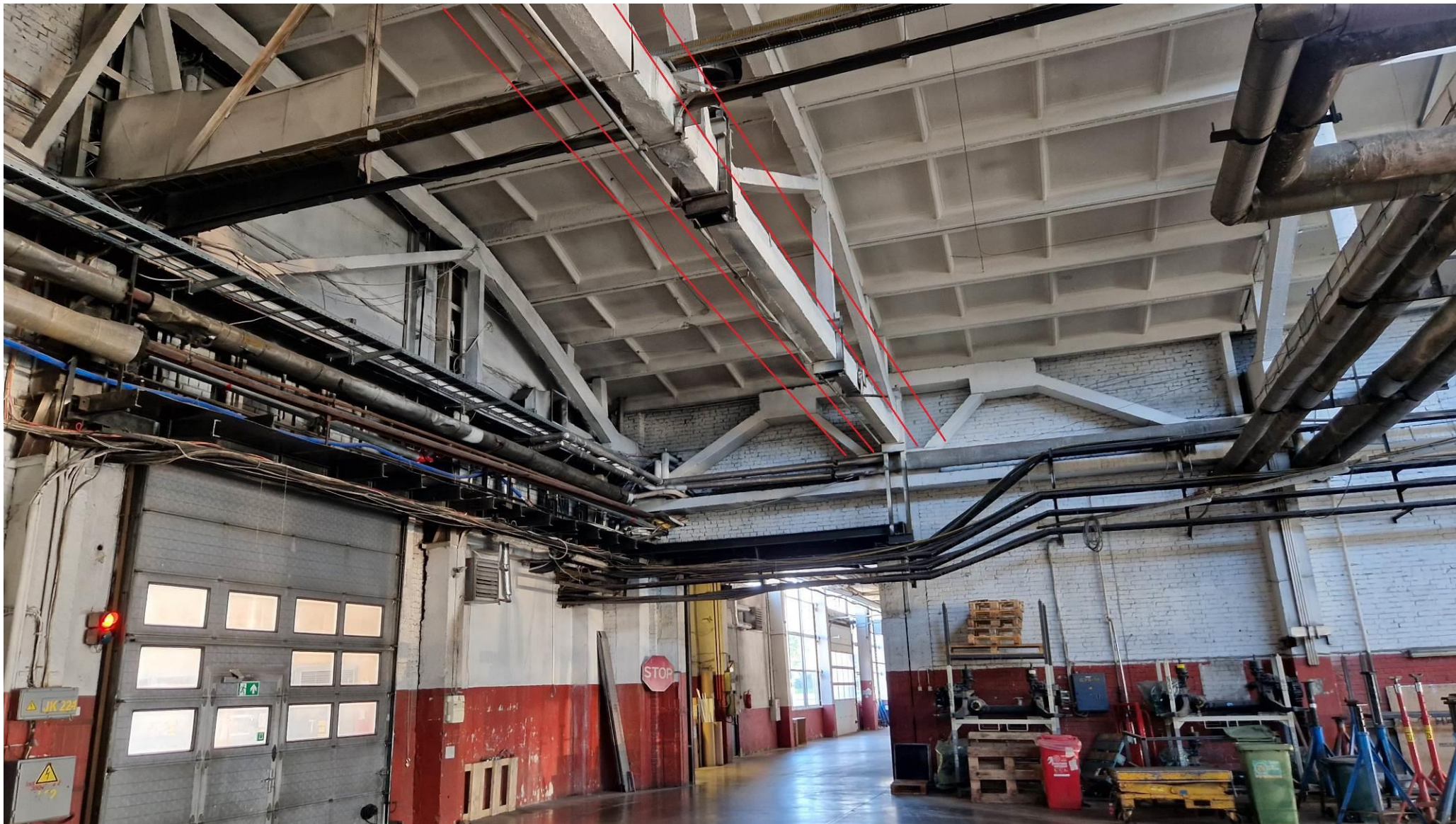
Foto nr 17: Vaade töökojast. Vaatel on näha võimalik trasside paigutus (administratiivhoone ja pääslohoone trass).
