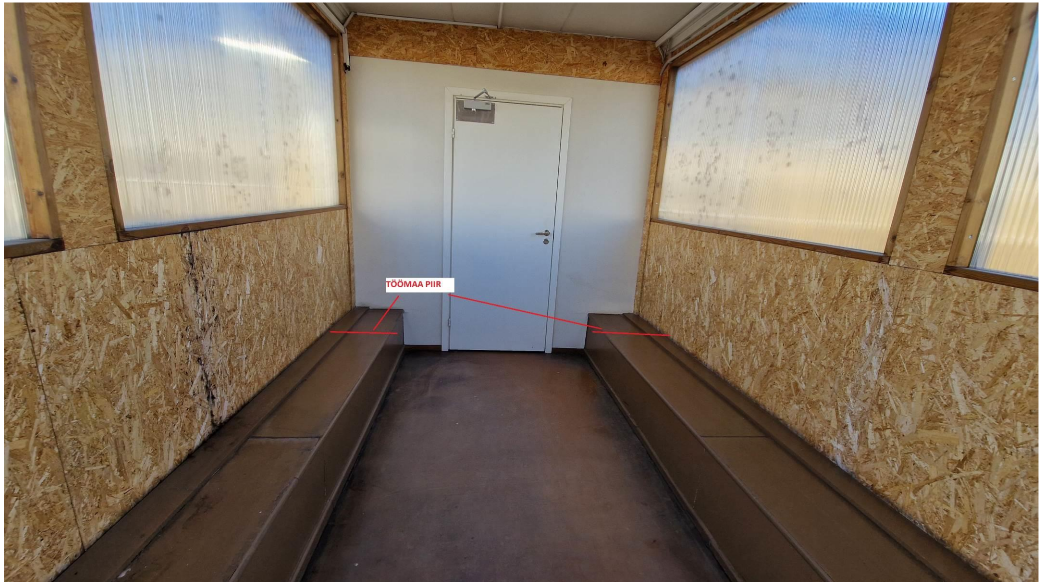
Foto nr 21: Vaade administratiivosast. Vaatel on näha töömaa piir (administratiivhoone trass on põrandapinna lähedal asuvates karbikutes).
