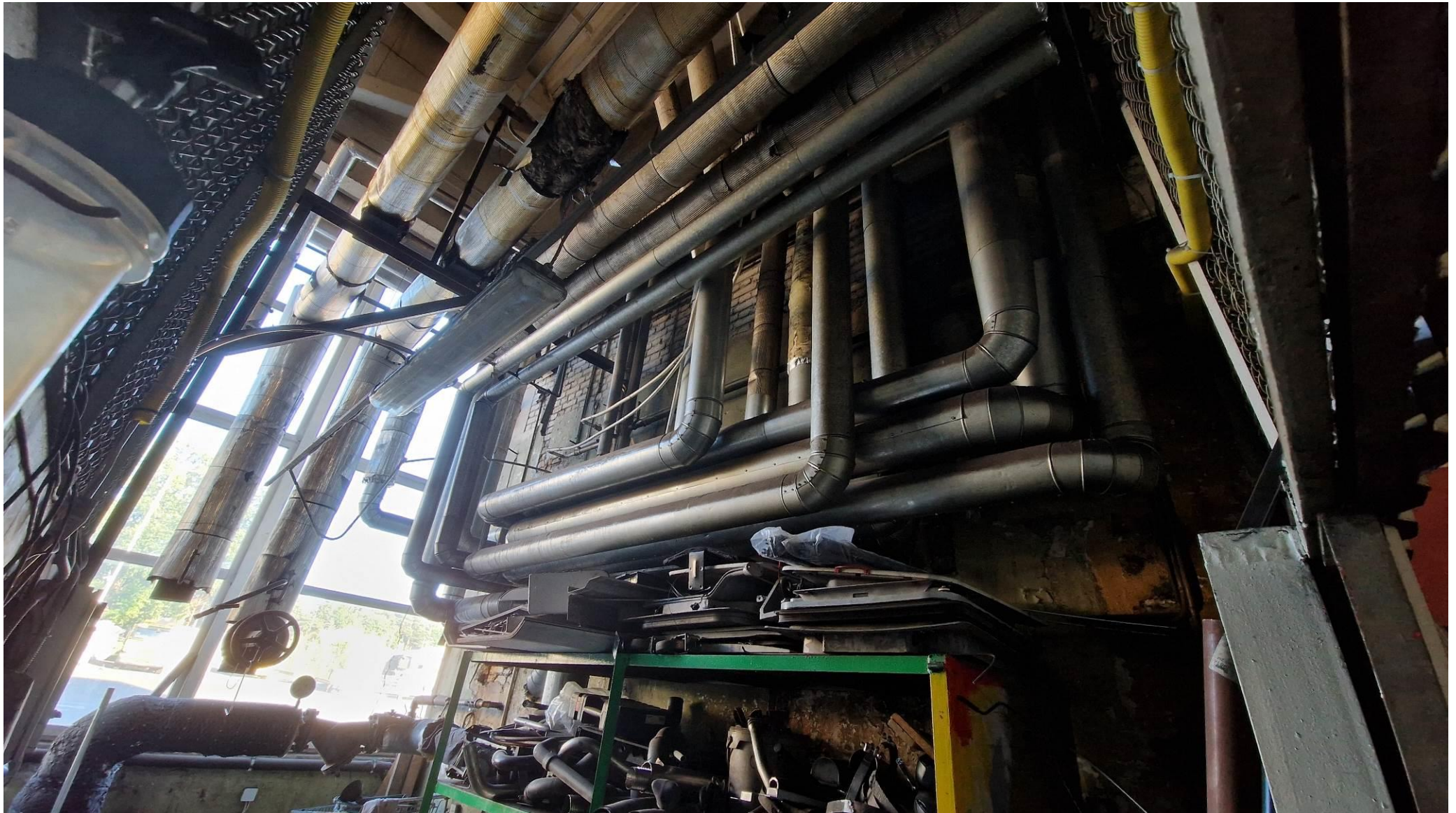
Foto nr 3: Vaade soojussõlme sisenevatele trassidele. Näha on valdavalt likvideerimisele minevad trassid.
